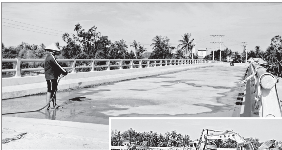
Cầu An Mỹ bắc qua sông La Tinh giữa xã Mỹ Chánh và Mỹ Cát (huyện Phù Mỹ) cơ bản hoàn thành.
